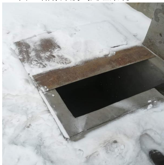
图 8 储存库 1.5m 3 事故池
