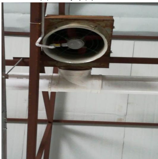
图 7 车间废气处理系统
